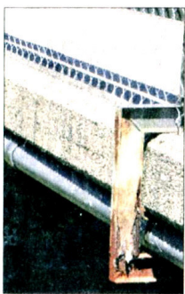
Bauliche Mängel im Detail: Rost
